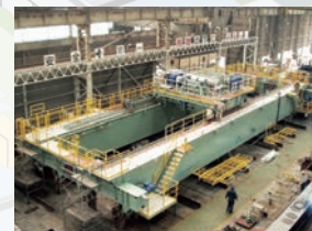
天井クレーン
